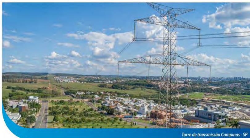
Torre de transmissão Campinas - SP
